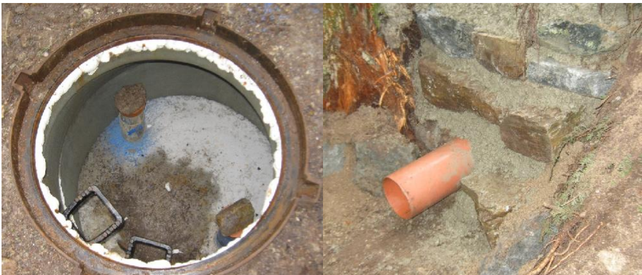
Abb. 6: Kontrollpegel und Überlaufsicherung Friedensstollen
